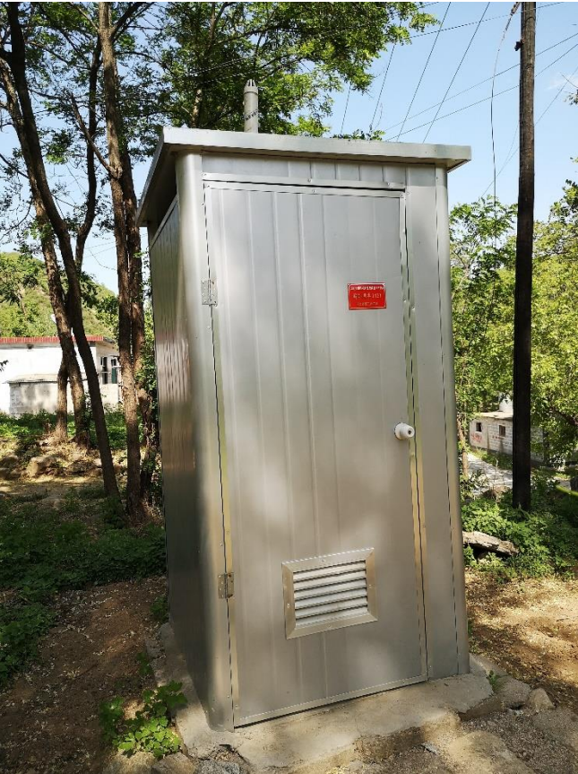
图 4-1 夏庄河北坡室外水冲厕
